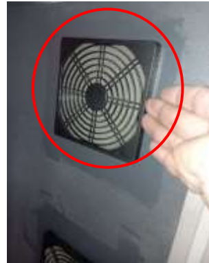
Imagen 8. Desensamble de filtro y rejilla para mantenimiento del mismo.
